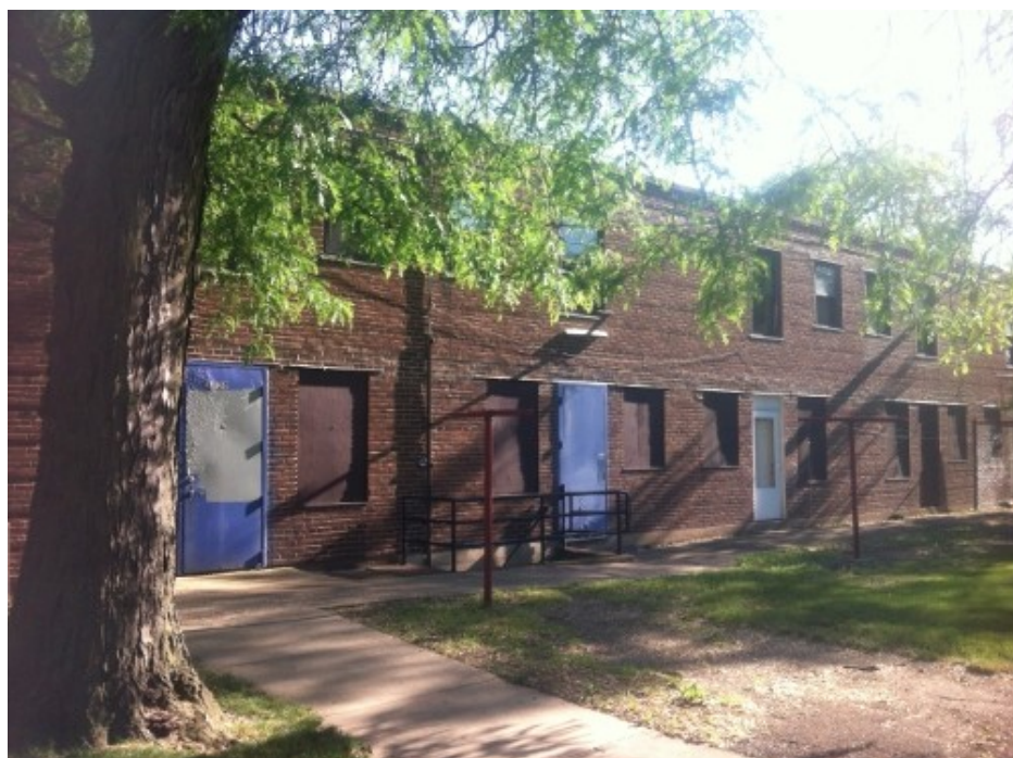
Figure 3. Logements murés et inoccupés à Lathrop Homes (2014)
