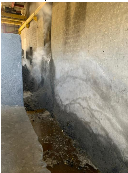
Figure 17 Fosse finale accueillant les mâchefers (Observation Usine d'incinération 29 février 2024)
