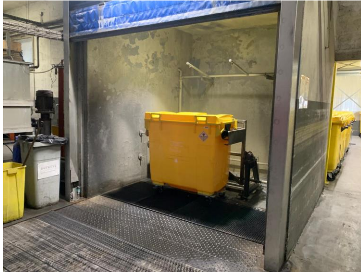
Figure 15 Cabine de lavage automatique (Observation Usine d'incinération 29 février 2024)
