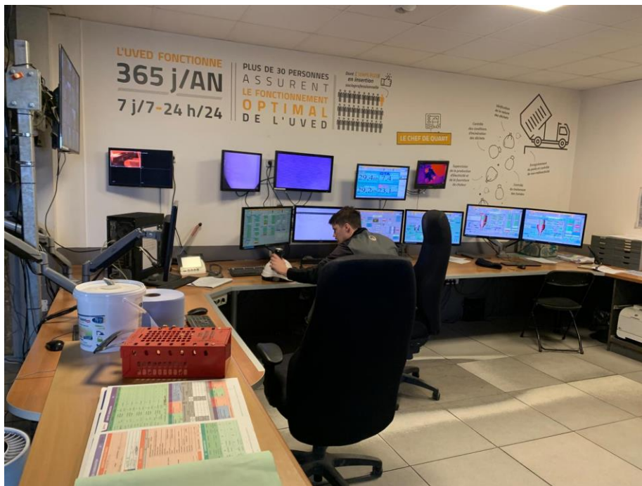
Figure 14 Salle de Commande (Observation Usine d'incinération 29 février 2024)
