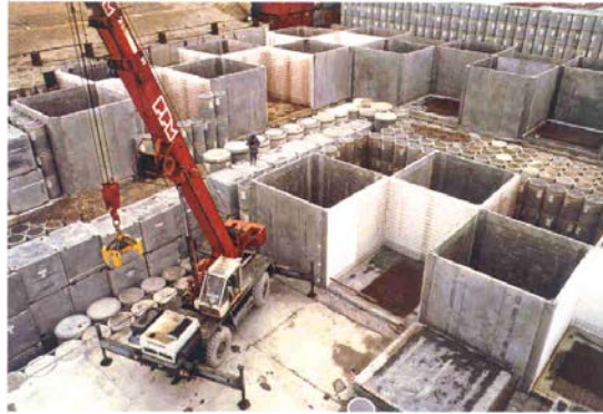
Stockage en monolithes de deuxième génération (1985) (Source, Mémoire Détaillée CSM, ANDRA 2008)
