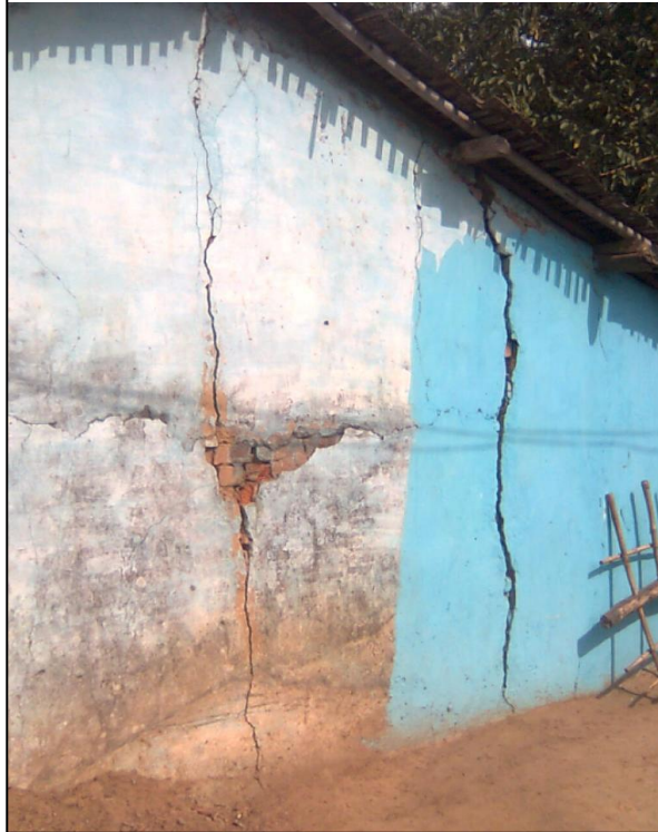
Illustration n°6.2 : Mur fissuré d'une maison d'Amora
