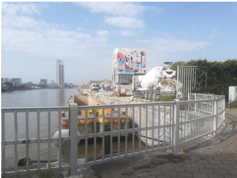
Photo 14. Centrale à béton à Bruxelles
