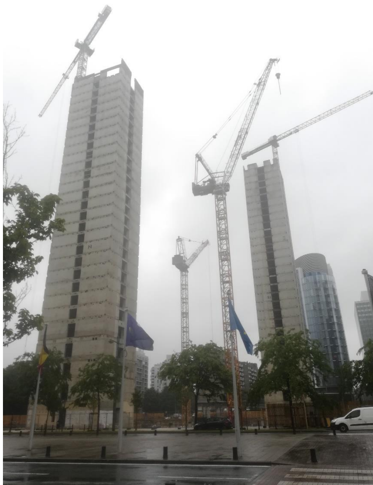
Photo 12. Les deux noyaux centraux conservés de la structure en bétons des tours WTC I et II
